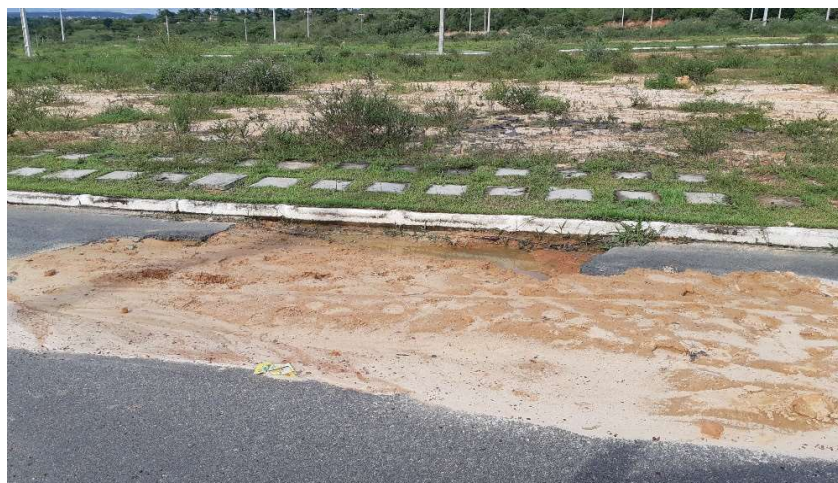
FOTO 37: RUA C4, NECESSITANDO DE RESTAURAÇÃO.
