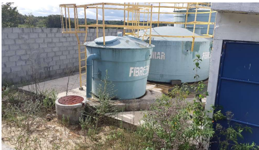
FOTO 10: ESTAÇÃO COMPACTA DE TRATAMENTO DE ESGOTO SANITÁRIO.
