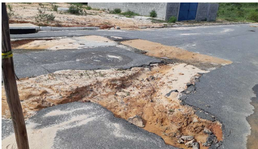
FOTO 21: RUA B, NECESSITANDO DE RESTAURAÇÃO.
