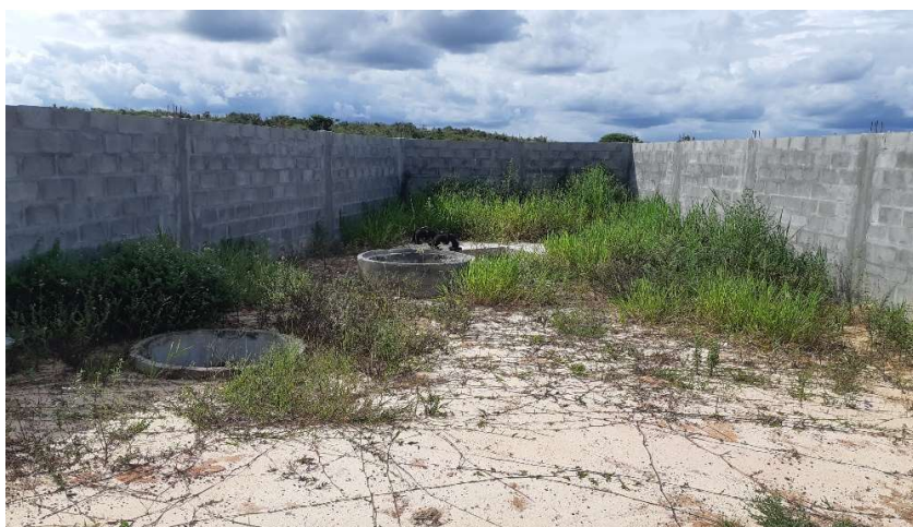
FOTO 05: ESTAÇÃO ELEVATÓRIA DE ESGOTO BRUTO.
