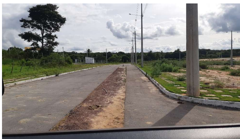
FOTO 27: RUA 1 EIXO 2, NECESSITANDO DE RESTAURAÇÃO.
