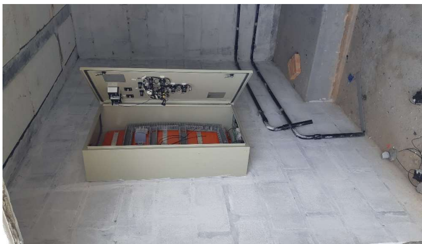
FOTO 12: ETE COMPACTA – PAINÉIS ELETRÔNICOS.
