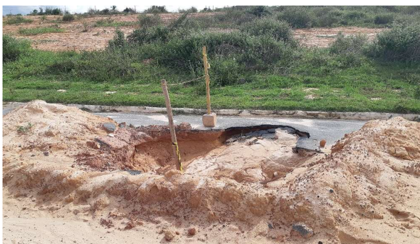
FOTO 24: RUA C7, NECESSITANDO DE RESTAURAÇÃO.
