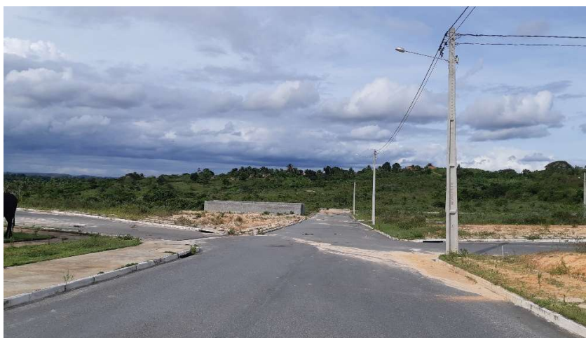
FOTO 20: RUA B, NECESSITANDO DE RESTAURAÇÃO.
