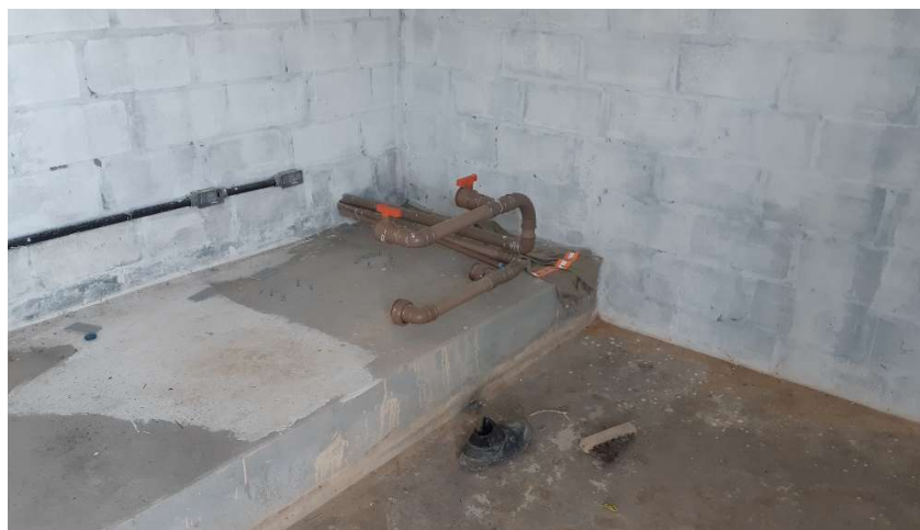
FOTO 13: ETE COMPACTA SEM BOMBAS ESTACIONÁRIAS.
