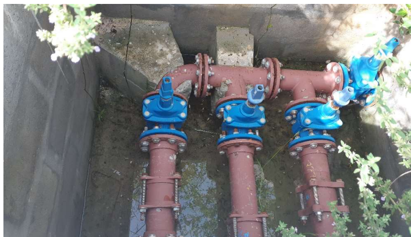
FOTO 07: ESTAÇÃO ELEVATÓRIA DE ESGOTO BRUTO.
