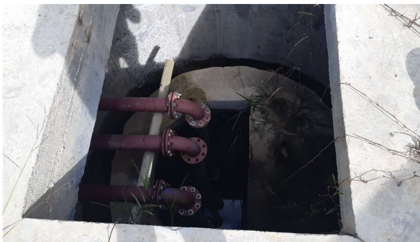
FOTO 06: ESTAÇÃO ELEVATÓRIA DE ESGOTO BRUTO.
