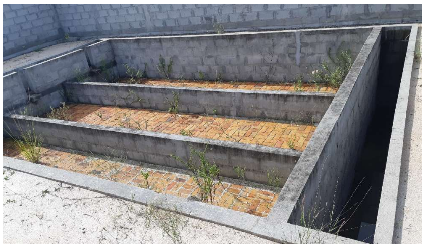
FOTO 11: ESTAÇÃO COMPACTA DE TRATAMENTO DE ESGOTO SANITÁRIO.
