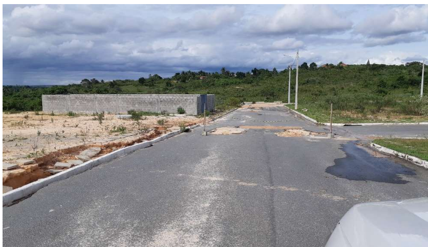
FOTO 19: RUA B, NECESSITANDO DE RESTAURAÇÃO.
