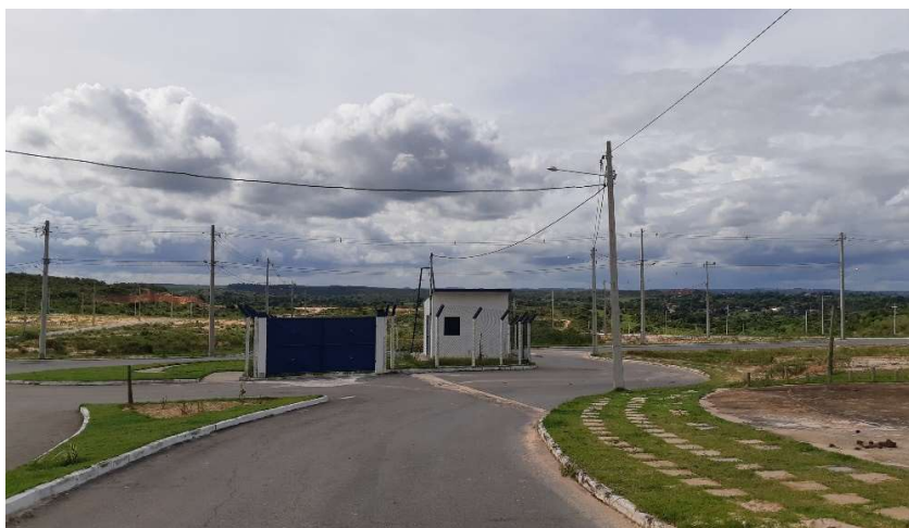
FOTO 03: LOCAL DESTINADO AO POÇO TUBULAR E CAIXAS DE PASSAGEM DA TUBULAÇÃO EXISTENTE.
